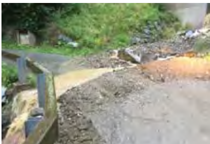
Überschwemmung des Maltaberger Weges
